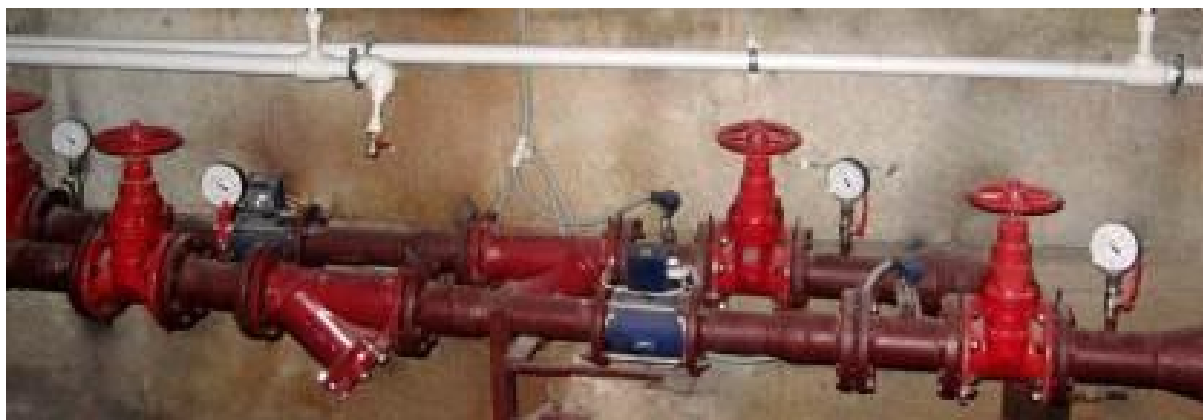
Рисунок 1 - Фотография узла учета тепловой энергии
